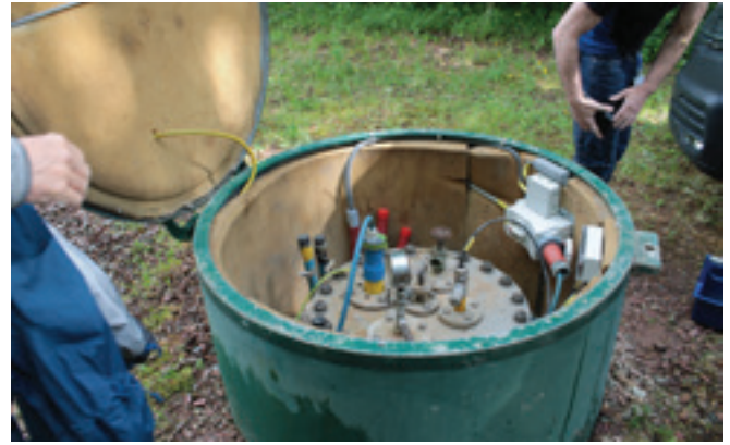
Figuur 33: Een van de oudere putten, waarvan er 4 zijn. Deze putten werden gebruikt om water te winnen uit zowel het 3e als het 4e aquifer. Later werden acht nieuwe putten gebouwd (figuur 34), vanwege een noodzakelijke toename van de onttrekkingscapaciteit. De oudere putten bleven alleen uit één van de twee aquifers winnen.
